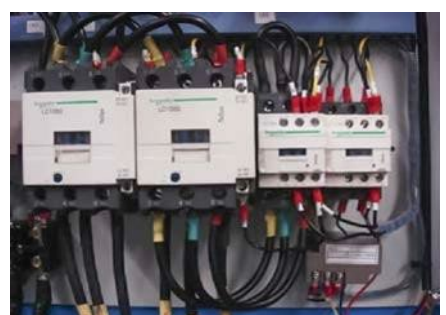
Рис. 8. Концы входного провода
